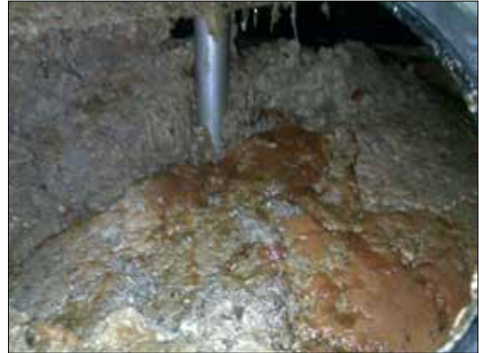
Schwere Ablagerungen von Fett in einem Fettabscheider wegen fehlender regelmäßiger Entsorgung des Gesamteinhalts.
